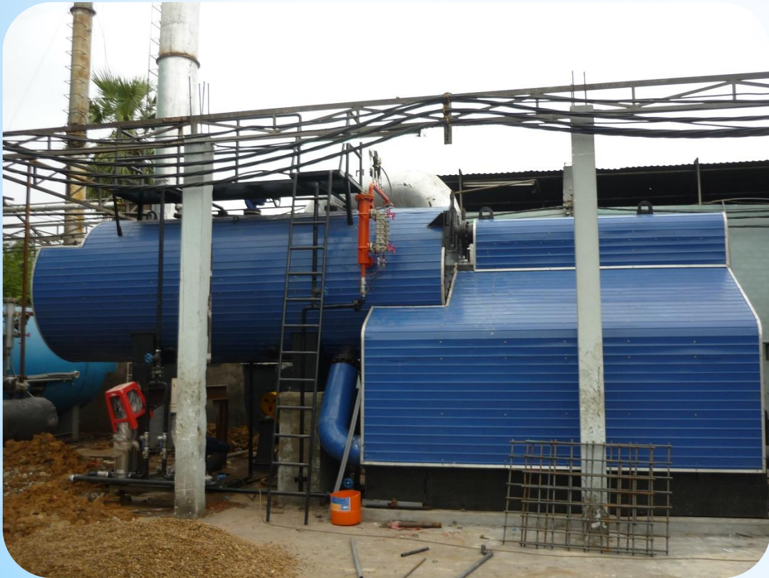
Lò hơi đốt than, củi
